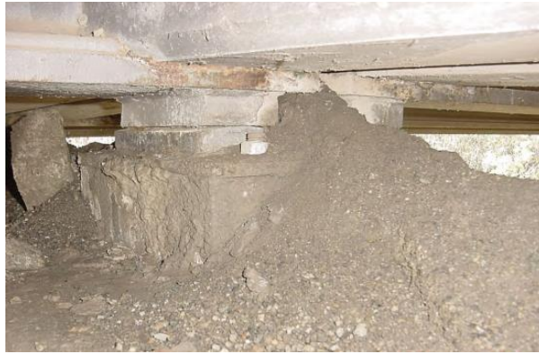
ຮູບທີ 3.2.2 ດິນຕົມ ແລະ ຊາຍສະສົມຢູ່ບໍລິເວນຖານຮອງໜອນຂົວ
